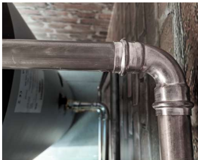
Figura 16 - inoxPRES UNIKO - Impianto di riscaldamento
